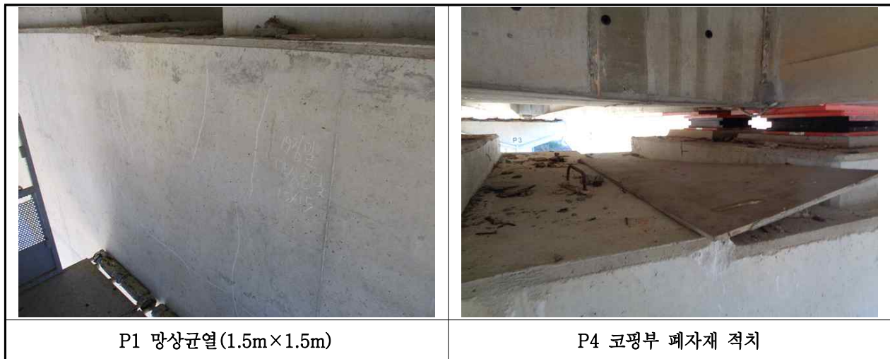
【사진 20.3.11】 교각 손상현황
