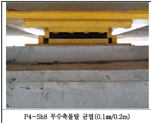
【사진 20.3.36】 교량반침 손상현황
