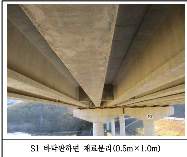
【사진 20.3.3】 바닥판하면 손상현황
